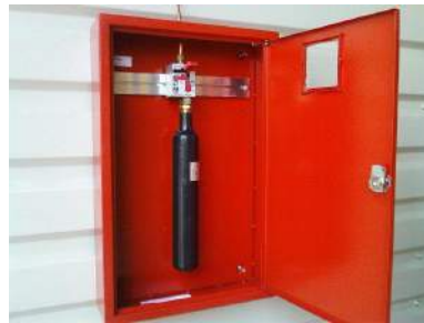
Рис. 1 Щит управления CO 2
